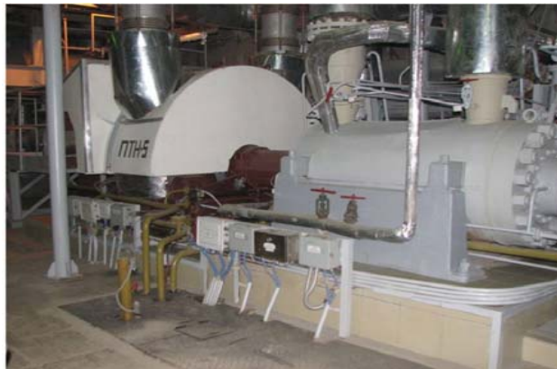
Турбопривод Р-3,7-1,28/0,2 П к питательному насосу ПН-500-185 Иркутская ТЭЦ-11 2011 г.
