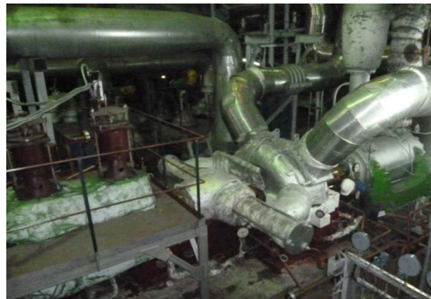
Турбопривод Р-3,15-1,28/0,2 П к питательному насосу ПН-500-185 Ново-Кемеровская ТЭЦ 2012 г.
