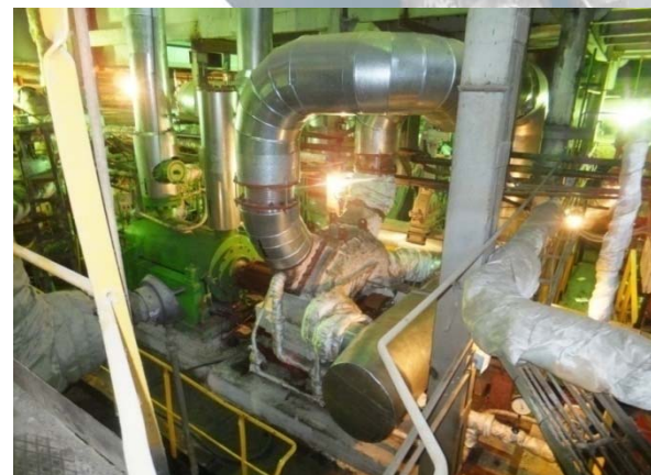
Турбопривод Р-4,7-1,08/0,15 П к питательному насосу ПН-720-185 Красноярская ТЭЦ-1 2012 г.
